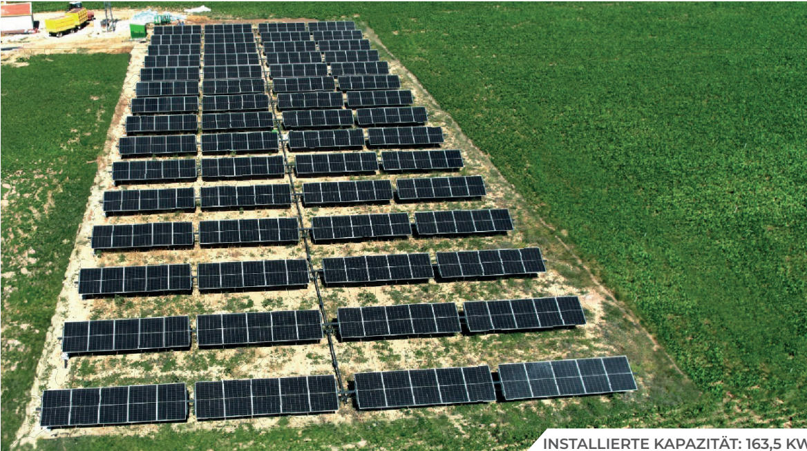
INSTALLIERTE KAPAZITÄT: 163,5 KWP
